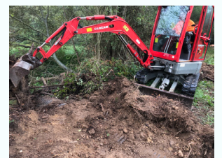
Ouverture de l'annexe hydraulique
