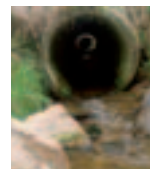
Buse infranchissable pour le poisson
